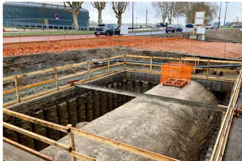
Les travaux se concentrent sur le Ris, une gigantesque canalisation longue de plus d'un kilomètre
