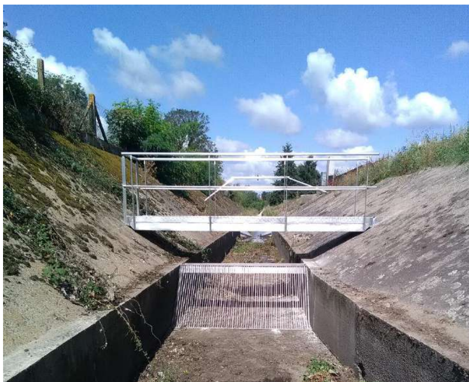
Mise en place d'un dégrilleur sur le by-pass de la STEP des Isles
