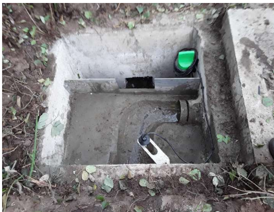
Amélioration de l'auto-surveillance des ouvrages (ici PR Fongroix à Lury-Lévis)
