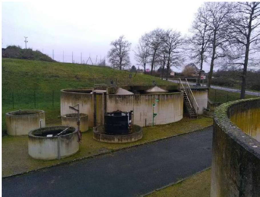
La station d'épuration de Lurcy-Lévis
